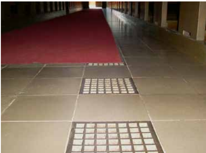
Lämmitysaukot kirkkosalin keskikäytävällä.
